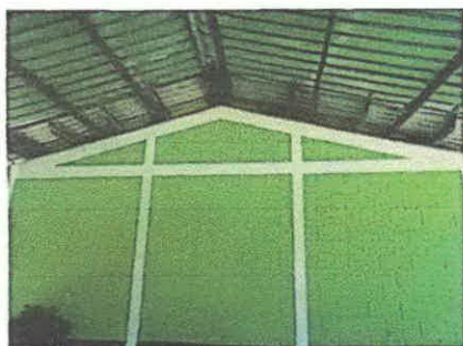
Foto 9: Entran roedores y polvo entre pared y techo, se necesita cerrar espacios.
